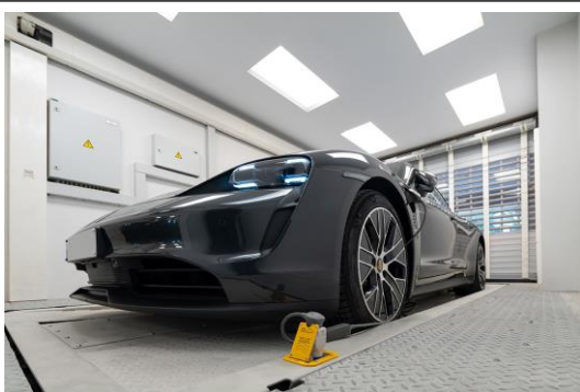
Bild 1: Übergabekabine des Multiparkers 740. Von hier aus wird das Auto vollautomatisch eingelagert.
